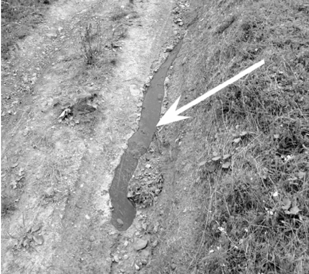
Рис.4. Оголення трубопроводу в межах дороги (околиця с. Корецьке)
